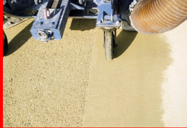
Pour le traitement de la couche de roulement, c'est la technique de l'hydroprojection qui a été retenue
