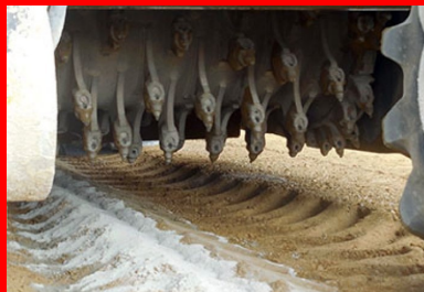
La puissance du rotor du malaxeur garantit une bonne homogénéisation verticale et transversale du mélange liant hydraulique-matériau fragmenté de l'ancienne chaussée
