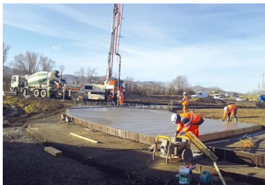
Le coulage de l'anneau en béton a été réalisé en une seule journée, avec l'utilisation d'une pompe à béton automotrice.
