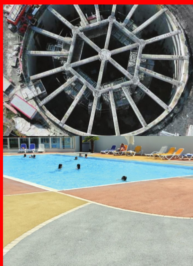
Bassin d'orage de Chaudé Rivière, Communauté urbaine de Lille. Cet ouvrage de lutte contre les inondations se compose de deux bassins circulaires en béton, reliés par un canal de surverse de l'un vers l'autre.
