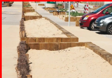
Un béton faiblement désactivé a été mis en œuvre, notamment sur la place des Basques.
