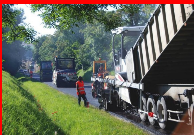
Application de la couche de roulement après retraitement des zones endommagées (10 000 t de BBSG 0/10 avec 30 % d'agrégats d'enrobés).
