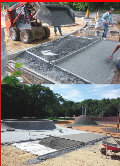
Le béton a été acheminé à l'aide d'une chargeuse et mis en œuvre manuellement par l'équipe de Val-de-Loire Environnement.
