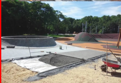
Après la mise en place d'un géotextile, l'entreprise positionne les joints de dilatation et les règle-joints de retrai/flexion, qui serviront de ce rage pour la mise en œuvre du béton drainant.
