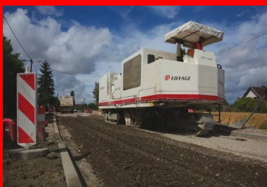
En milieu urbain, la présence de bordures, de tampons de voirie ou de bouches à clé n'empêche pas la mise en œuvre du retraitement en place. Solution choisie par Eiffage-Route sur ce chantier : les abaisser, avant de les relever.
