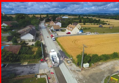
Fin juin 2017, à Demigny (Saône-et-Loire). Après épandage du liant hydraulique routier Vicat (LV-TS03) par l'Arc Dosage (en haut de la photo), l'ARC 1000 (au premier plan) décohesionne les matériaux de l'ancienne chaussée et procède à un puissant malaxage pour obtenir un mélange homogène.
