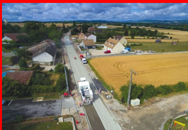
Fin juin 2017, à Demigny (Saône-et-Loire). Après épandage du liant hydraulique routier Vicat (LV-TS03) par l'Arc Dosage (en haut de la photo), l'Arc 1000 (au premier plan) décohésionne les matériaux de l'ancienne chaussée et procède à un puissant malaxage pour obtenir un mélange homogène.
