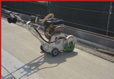
Des amorces de fissuration ont été réalisées par sciage au plus vite après le bétonnage. But : le développement rapide de fissures plus droites et régulières, réduisant le risque de regroupement.
