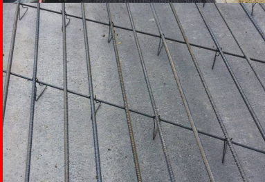
disposées tous les 170 mm, les armatures longitudinales ont un diamètre de 20 mm. Espacées de 700 mm, les armatures transversales (12 mm de diamètre) les croisent selon un angle de 60°.
