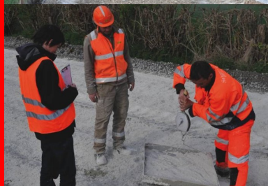
Vérification de la quantité de liant hydraulique épanché par mètre carré, avec passage d'un échantillon étalonné.
