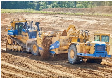
Extraction et transport des matériaux à l'aide de scrapers poussés par des bulldozers et stockage provisoire des déblais. © Guintoli - NGE
