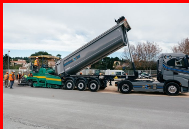
Un camion-benne, bâché durant le transport du BCR, déverse le matériau dans le finisseur. Celui-ci répand, nivelle et compacte le BCR. (©Colas)
