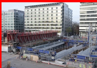
Vue globale montrant l'aire de préfabrication des méga-poutres (poutre coffrée, banches rouges).
