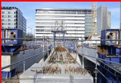
Vue d'une poutre à sa position définitive. Aperçu des équipements de manutention lourde : portique de levage et chemin de ripage.
