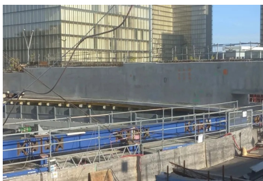
Les méga-poutres sont ripées sur des chemins de ripage, eux-mêmes appuyés sur des files situées 3 m plus bas par l'intermédiaire de palets.
