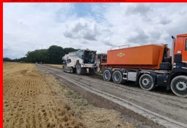
Malaxage du matériau et du liant ROC VDS à l'aide d'un malaxeur Wirtgen 250i et humidification du mélange par injection dans la cloche du malaxeur. (©Colas)
