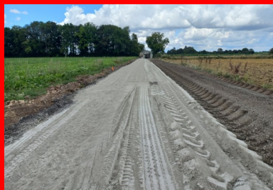
Épandage du liant ROC VDS à la surface des fraisats d'enrobé à l'aide de l'épandeur Streumaster SW18CI (LTV 333). (©Colas)
