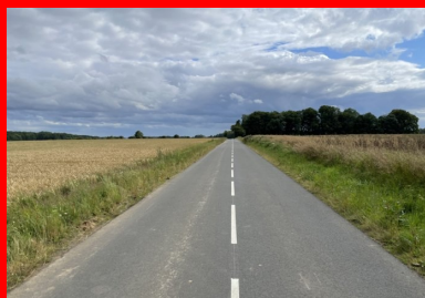
Réhabilitation de la RD119 achevée. Accotements rehaussés et signalisation horizontale réalisée. (©Fenêtre sur cour)
