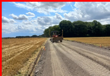
Régalez des fraisats d'enrobés et mise au profil à l'aide d'une niveleuse guidée par GPS. (©Colas)
