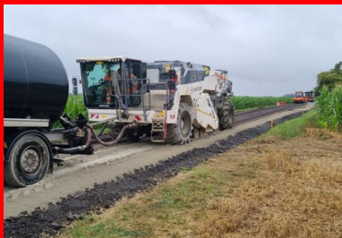
Section 3, Atelier de retraitement mixte au liant ROC VDS (liant épanché au sol) et à l'émulsion de bitume (injectée directement dans la cloche du malaxeur). (©Colas)
