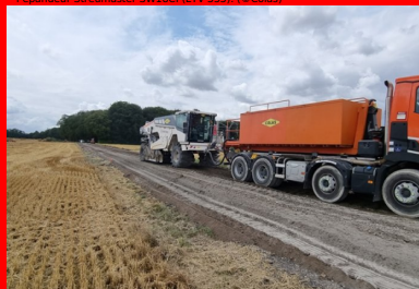
Malaxage du matériau et du liant ROC VDS à l'aide d'un malaxeur Wirtgen 250i et humidification du mélange par injection dans la cloche du malaxeur. (©Colas)
