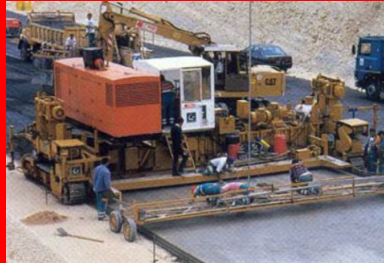
Mise en oeuvre du béton à l'aide d'une machine à coffrages glissants.
