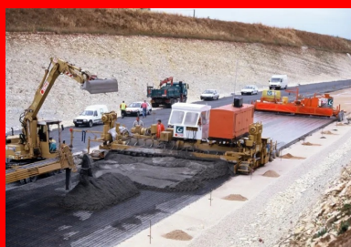
RN 141. Déviation des Rassats-Favrauds- Mise en oeuvre de la chaussée composite en BAC/GB3 en 1998. Cette structure assure parfaitement son rôle aujourd'hui sans avoir fait l'objet d'entretien structurel (cf. interview Gilles Lacassy, DIRA).
