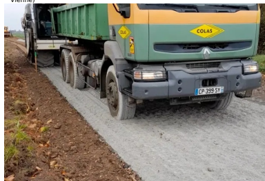
Malaxage du matériau de l'ancienne chaussée avec le liant Ligex M10 sur une profondeur de 35 cm à l'aide d'un pulvimixeur moderne Wirtgen WR240i, permettant d'obtenir un matériau homogène sur toute l'épaisseur et sur toute la largeur de la nouvelle chaussée. (©Ludovic Padeloup/Conseil départemental de la Vienne)
