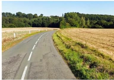
État de la chaussée de la RD7 sur la commune de Brux, avant les travaux de réhabilitation. (© Ludovic Pasdeloup/Conseil départemental de la Vienne)
