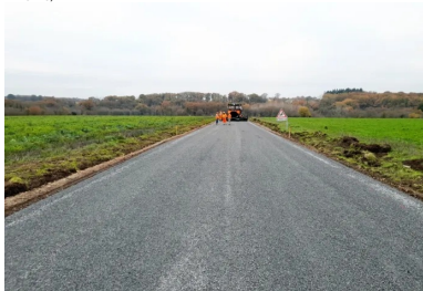
Mise en œuvre de la couche de surface en EB10. (©Ludovic Padeloup/Conseil départemental de la Vienne)
