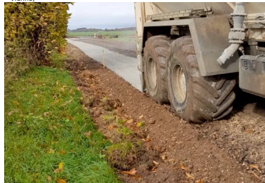
Épandage du liant Ligex M10 à raison de 35 kg/m 2 (dosage 5%) à l'aide d'un épandeur moderne doté d'un système de dosage volumétrique asservi à la vitesse d'avancement. (©Ludovic Padeloup/Conseil départemental de la Vienne)
