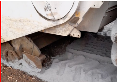
Malaxage du matériau de l'ancienne chaussée avec le liant Ligex M10 sur une profondeur de 35 cm à l'aide d'un pulvimixeur moderne Wirtgen WR240, permettant d'obtenir un matériau homogène sur toute l'épaisseur et sur toute la largeur de la nouvelle chaussée. (©Ludovic Pasdeloup/Conseil départemental de la Vienne)
