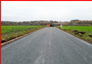
Mise en œuvre de la couche de surface en EB10. (©Ludovic Pasdeloup/Conseil départemental de la Vienne)
