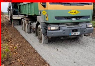
Malaxage du matériau de l'ancienne chaussée avec le liant Ligex M10 sur une profondeur de 35 cm à l'aide d'un pulvérisateur moderne Wirtgen WR240, permettant d'obtenir un matériau homogène sur toute l'épaisseur et sur toute la largeur de la nouvelle chaussée. (©Ludovic Padeloup/Conseil départemental de la Vienne)
