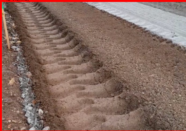
Malaxage du matériau de l'ancienne chaussée avec le liant Ligex M10 sur une profondeur de 35 cm à l'aide d'un pulvimixeur moderne Wirtgen WR240, permettant d'obtenir un matériau homogène sur toute l'épaisseur et sur toute la largeur de la nouvelle chaussée. (©Ludovic Pasdeloup/Conseil départemental de la Vienne)
