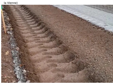
Malaxage du matériau de l'ancienne chaussée avec le liant Ligex M10 sur une profondeur de 25 cm à l'aide d'un pulvimixeur moderne Wirtgen WR240i, permettant d'obtenir un matériau homogène sur toute l'épaisseur et sur toute la largeur de la nouvelle chaussée. (©Ludovic Padeloup/Conseil départemental de la Vienne)
