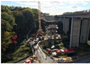
Les nombreuses contraintes d'accessibilité au fond de cette vallée encaissée ont conduit à réaliser une déviation et un pont provisoires ainsi qu'une paroi de soutènement clouée...
