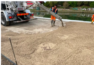
Le béton est acheminé à pied d'œuvre par camion-toupie et déversé sur la fondation en grave traitée au LHR. (©Sébastien Vinatier/Sols)
