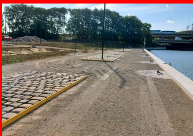
Vue du chantier avant le coulage du béton, montrant la fondation en grave traitée au LHR, les coffrages posés, les bordures de rive et le pavage. (© Sébastien Vinatier/Sols)
