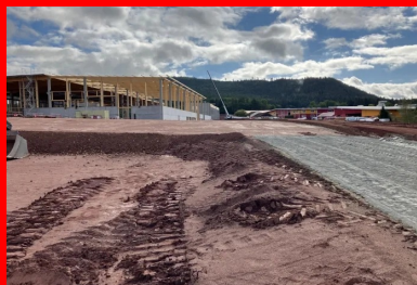
Vue générale du projet d'extension, avec au premier plan la plate-forme des aménagements extérieurs en cours de traitement au liant LV-TS 54. (© Scierie-Gaiffe et Avinim Construction)
