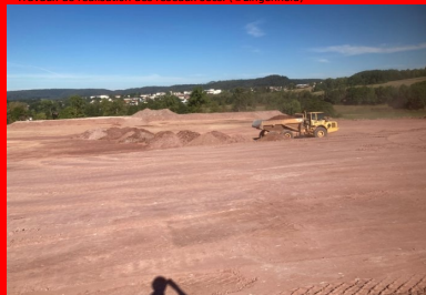
Mouvement de terre. Le matériau est acheminé et mis en place en couches d'épaisseur variable en fonction de la zone, afin de conférer à la plate-forme les caractéristiques topographiques visées. (© Scierie-Gaiffe et Avinim Construction)
