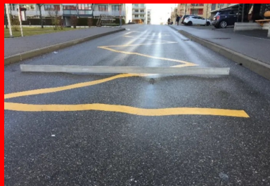
Photo 3 : arrêt de bus déformé - (c) CIMBETON
