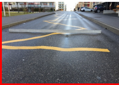
Photo 3 : arrêt de bus déformé - (c) CIMBETON
