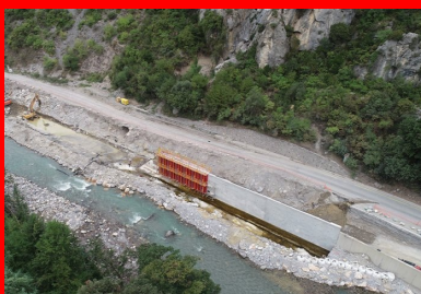
Saorge, RD 6204, Brèche n° 12 : réalisation d'un mur cantilever en béton coulé en place.
