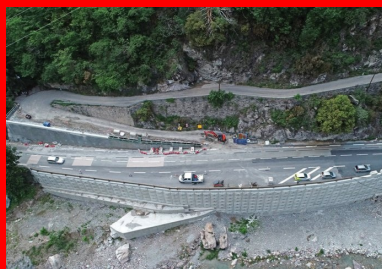
RD 6204. Réalisation d'une paroi AD/OC® et d'une paroi clouée en béton projeté pour la brèche 18b.
