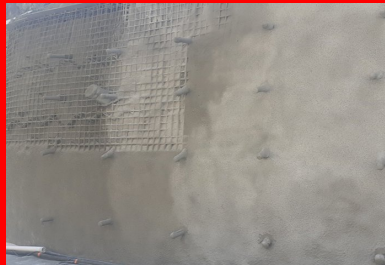
Paroi clouée, brèche n° 40.
