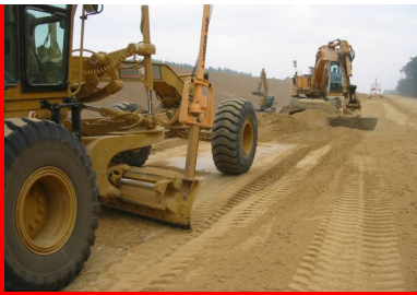
Mise à la côte du matériau avant le passage de l'atelier de traitement. (©Colas)
