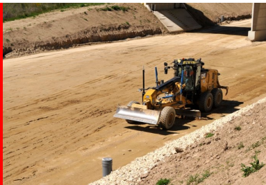
Réglage à la niveleuse pour obtenir un profil en long très régulier. (© Colas)
