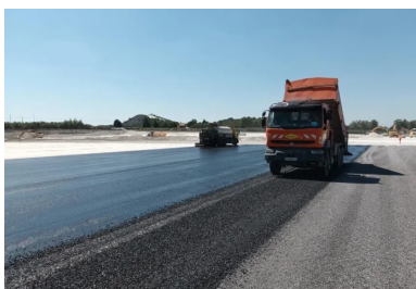
Atelier de mise en œuvre de l'enduit bicouche clouté dont le rôle est d'assurer la protection du sol traité. (© Colas)
