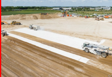
Atelier de traitement. Au fond un épandeur de liant en action et au premier plan deux pulvimixeurs mélangent le liant avec le sol sur une épaisseur bien définie. (©Colas)
