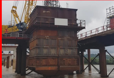
Chaque fût de pile est bétonné à l'intérieur d'un caisson étanche solidarisé au pieu de fondation, ce qui permet de limiter les affouillements.
