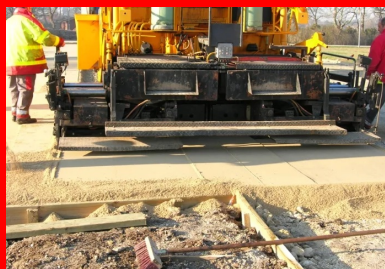
Mise en œuvre par bandes du sable stabilisé au liant Stabex au finisseur. (©CIMbéton)
