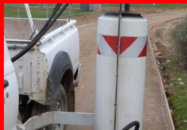
Vérification de la portance de la plate-forme support à la dynaplaque. (©CIMbéton)
