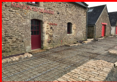
Après avoir réalisé les coffrages et le pavage, le treillis soudé est positionné sur des cales au tiers inférieur du revêtement en béton. (©Phytolab)
