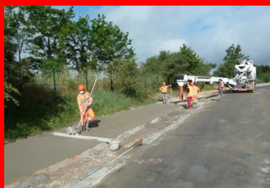
Mise en œuvre manuelle du béton, livré par camion-toupie équipé de tapis. (©CIBéton)
