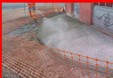
Pulvérisation du produit dénudant Agent dénudant Via Stone® Drain. (©Jean-Sébastien Deborde, Ingepro).
