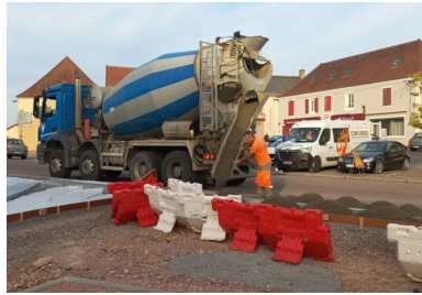
Le béton drainant est déversé entre coffrages sur la plate-forme support. (©Grégory Charpenet, Béton Vicat).
