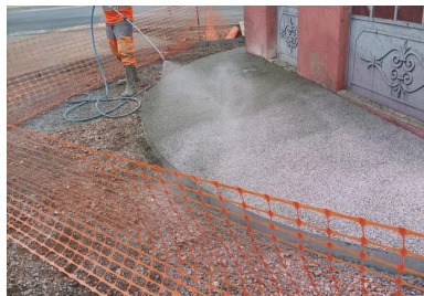
Pulvérisation du produit dénuant Agent dénuant Via Stone® Drain. (©Jean-Sébastien Deborde, Ingepro).
