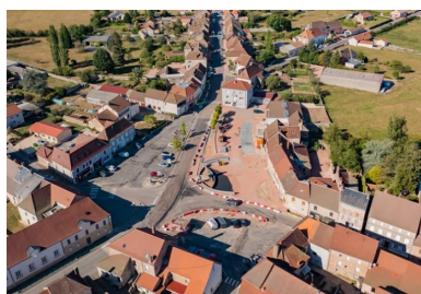
Vue de la place du Champ-de-Foire pendant les travaux. (©Jean-Sébastien Deborde, Ingepro).
