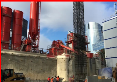
Levage de la cage d'armature d'une paroi moulée avant son installation dans la tranchée. Cette phase spectaculaire permet de se rendre compte des dimensions exceptionnelles de l'excavation.
