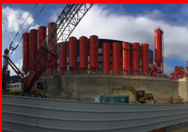
Après l'équipement de la tranchée avec la cage d'armature, des tubes plongeurs sont installés pour permettre le bétonnage en continu et sans interruption depuis le fond de la tranchée. Grâce à ces tubes, le béton se substitue au fluide d'excavation.
