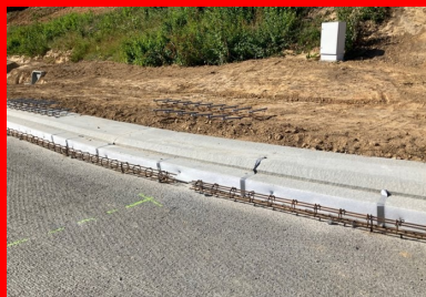
Les chainages ont été mis en place pour renforcer les bords de dalles sollicités ainsi qu'au droit des joints de dilatation. (© Quentin Hognon, Colas)
