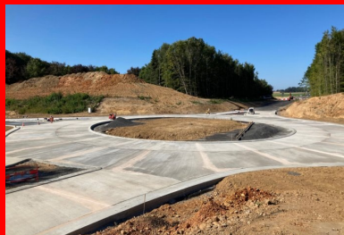
Vue du carrefour giratoire en béton en cours de finition. (© Joseph Abdo, JA-Consulting)
