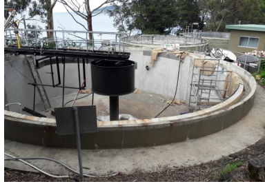
Bassin de décantation d'eaux usées réalisé en béton de ciments d'aluminate de calcium - Photo (c) Imerys
