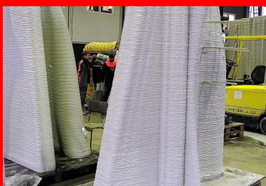
Des coques en béton imprimées 3D par dépôt de couches successives sont apposées sur la structure en béton armé pour servir de coffrage.
