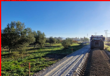
La malaxeur moderne Wirtgen WR 240 mélange le liant LVTS 13 avec le sol intimement sur une épaisseur foisonnée de 35 cm. (© B. Montagnini _Ecostab)
