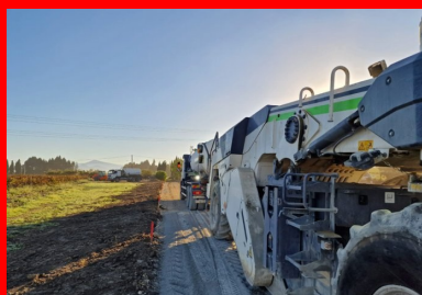
Le traitement des matériaux du site avec un liant hydraulique routier est une technique incontournable dans le cas d'aménagement d'une voie étroite. (© Bruno Montagrin, Ecotab)
