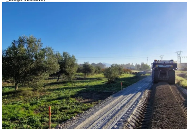
La malaxeur moderne Wirtgen WR 240 mélange le liant LVT5 13 avec le sol intimement sur une épaisseur foisonnée de 35 cm. (© B. Montagnini _Ecostab)
