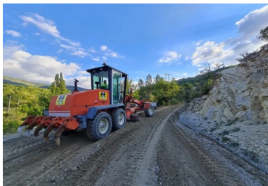
Le pré-réglage du matériau traité à l'aide d'une niveleuse, avant le compactage. (© B. MONTAGNINI _ECOSTAB)
