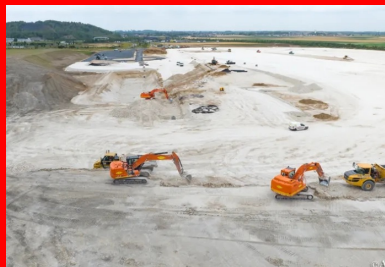
Vue générale du chantier de terrassément, conçu en circuit fermé déblais-remblais. (© Colas/ArtoisDrones)
