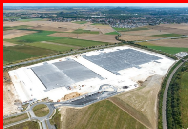
Vue générale de la plate-forme support traitée au ROC VDS et achevée, prête à recevoir les bâtiments, les aménagements extérieurs et les voiries. (© Colas/ArtoisDrones)
