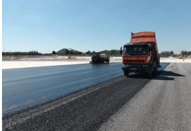
Enduit bicouche clouté qui assure la protection de la couche de forme traitée. (©Colas)
