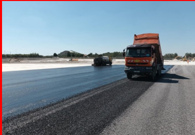
Enduit bicouche clouté qui assure la protection de la couche de forme traitée. (© Colas)
