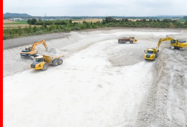
Reprise sur stock à l'aide d'une pelle sur chenilles et de tombereaux articulés. (© Colas)
