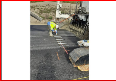
Paniers de goudjons fixés sur la grave-bitume au droit des joints de retrait. (©Eric Sainquantin_DIRA)
