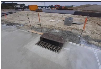
L'eau est canalisée vers des regards à grille. (© Eric Sainquantin, DIRA)
