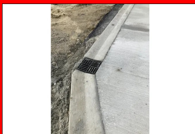
L'eau est canalisée vers des regards à grille. (© Joseph Abdo, JA-Consulting)
