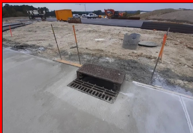
L'eau est canalisée vers des regards à grille. (© Eric Sainquantin, DIRA)
