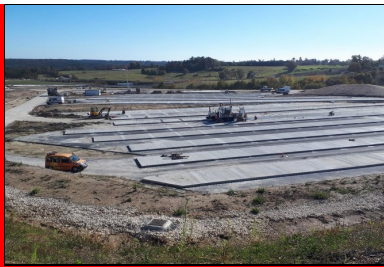
Application de la technique du clivage. Coulage d'une bande sur deux. (© Luc Lefol, Eurovia)
