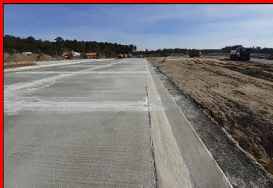
Les eaux de ruissellement sont recueillies dans des caniveaux en béton. (© Eric Sainquantin, DIRA)
