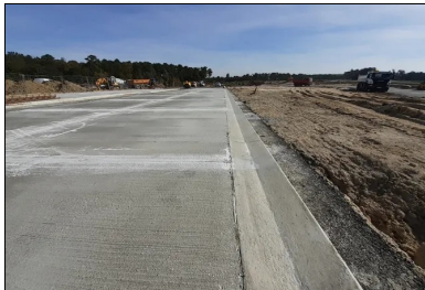
Les eaux de ruissellement sont recueillies dans des caniveaux en béton. (© Eric Sainquantin, DIRA)
