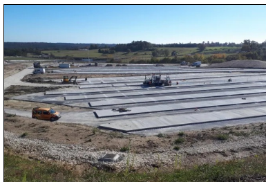
Application de la technique du clavage. Coulage d'une bande sur deux. (© Luc Lefoll_Eurovia)
