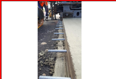
Insertion des goujons à mi-hauteur sur les deux flancs de la bande en béton. (© Luc Lefol, Eurovia)
