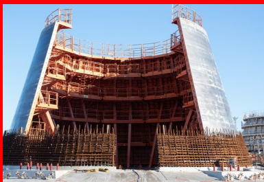
La partie conique du fût était coulée en deux levées successives de 11 m, grâce à des coffrages sur mesure.
