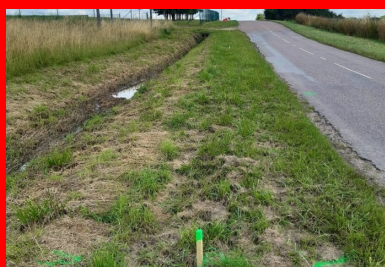
État de la chaussée avant les travaux.
