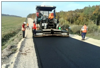
Mise en œuvre de la couche de surface en BBCS à l'aide d'un finisseur.
