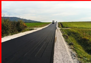
Compactage du BBCS. Mise à niveau des chemins d'accès aux parcelles agricoles.
