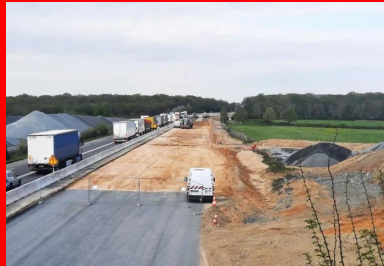
Vue générale du chantier de mise à 2x2 voies de la RN79 entre toulon-sur-allier et digoin.
