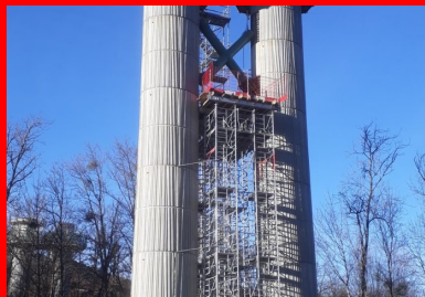
Une double pile en cours de construction. Les fûts des piles, coulés en place dans des coffrages elliptiques, sont ornés d'un motif en béton matricé. ©CEREMA
