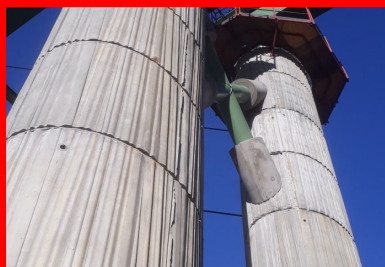
Pile en cours de construction. Les deux fûts sont entretoisés par une croix tubulaire métallique. Bien que reprenant des charges, cette croix répond d'abord à une finalité esthétique. ©CEREMA
