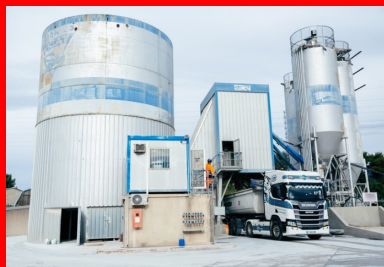
Centrale Béton VICAT où le BCR a été étudié pour optimiser sa formulation et fabriqué (© Béton Vicat)
