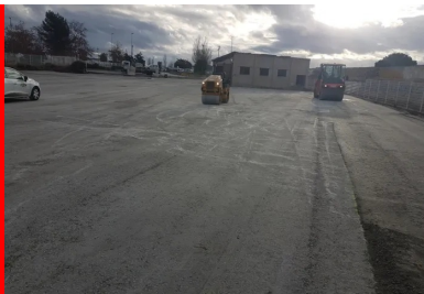
Compactage du BCR à l'aide de deux compacteurs vibrants VT2 et PV2. (© Colas)
