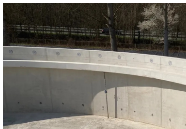
Les radiers de chaque bassin ont été coulés en une fois. Ils sont fondés sur des pieux en béton de grande capacité portante, réalisés selon la technique du refoulement de type INSER ©
