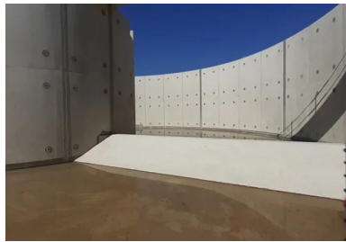
Les bétons des bassins de la station d'épuration sont formulés pour pouvoir résister aux attaques chimiques des effluents en cours de traitement.
