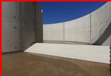
Les bétons des bassins de la station d'épuration sont formulés pour pouvoir résister aux attaques chimiques des effluents en cours de traitement.
