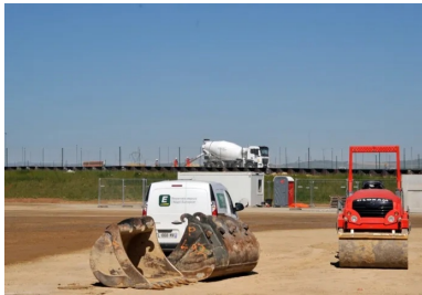
Trois types de compacteurs se sont chargés du compactage afin d'atteindre l'objectif q3 fixé : à bille lisse, à pieds dameurs et à pneus.
