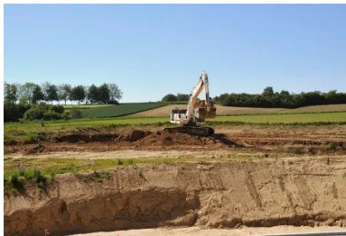
Les techniques utilisées ont permis le ré-emploi de la majorité des déblais du chantier afin de préserver les gisements locaux.
