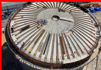
Une fois les pétales posés, la poutre de couronnement est bétonnée et les pétales clavés.
