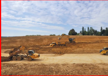
Les matériaux sont repris sur le stock à l'aide d'une pelle sur chenilles et de tombereaux articulés, puis mis en œuvre sur 40 cm par des bulls assistés par GPS.
