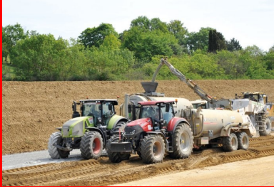
Apport d'eau par un tracteur directement dans la citerne pour éviter l'arrêt des engins.
