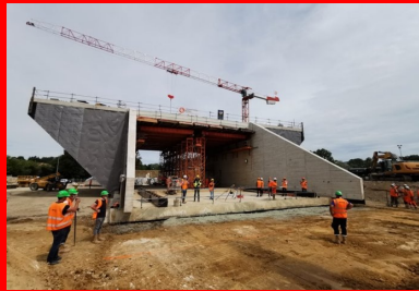
Une fois la brèche créée dans le remblai ferroviaire, le parcours de ripage a été scalpé à la bonne cote, afin de permettre à l'ouvrage de glisser sans effort excessif. Le ripage proprement dit a alors pu se dérouler : huit heures ont été nécessaires pour faire parcourir au pont-rail de quelque 6 500 tonnes les 49 mètres qui le séparaient de son emplacement définitif.
