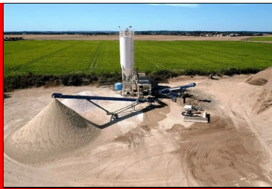
La plate-forme de revalorisation des matériaux inertes du BTP de RCM, implantée à Montereau-sur-le-Jard.
