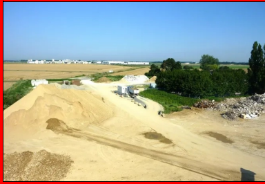
La zone de stockage de la plate-forme avec différents matériaux (sables, gravillons, déblais...).
