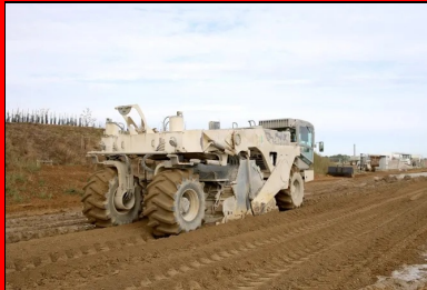
Le malaxage a été effectué à l'aide de la stabilisatrice Wirtgen 2400. Pour s'assurer de la bonne interface PST-CDF, 1-2 cm du traitement de la PST a été systématiquement repris.
