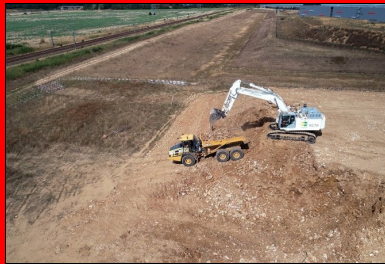
Les terrassements ont permis la réalisation d'un remblai « d'une hauteur de 7 m ».
