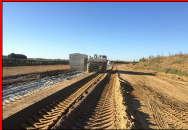
L'épandage du liant hydraulique routier ROC VDS (soit plus de 29 kg/m 2 ) à la surface du matériau à l'aide d'un épandeur à dosage asservi à l'avancement, suivi d'un malaxage à l'aide de la stabilisatrice Wirtgen 2400.
