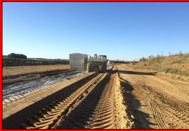
L'épandage du liant hydraulique routier ROC VDS d'EQUIOM à raison de 4,75 % (soit plus de 29 kg/m 2 ).
