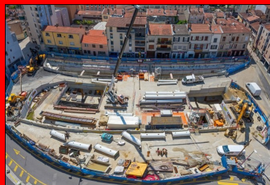
© ACTOPHOTO Station Oullins Centre : l'emprise du chantier est à peine plus grande que la dalle de couverture de la gare.
