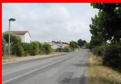
L'avenue Gilbert-Burlot avant les travaux. On constate l'absence de piste cyclable sécurisée et l'état de dégradation structurelle de la chaussée.
