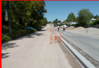
Après les travaux préparatoires de la piste cyclable, la bordure en béton - séparant la piste cyclable/moue de la chaussée - a été coulée en place à l'aide d'une machine à coffrages glissants.
