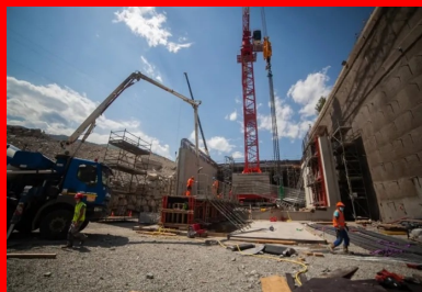
Le chantier de construction de la tranchée couverte (au centre) est réalisé à l'abri d'une paroi berlinoise (à droite).
