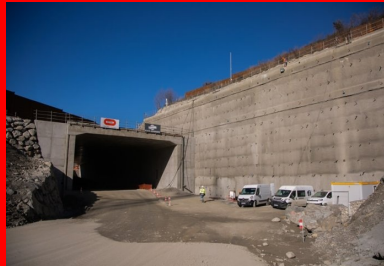
La tranchée couverte dégage une section libre de 18 m de large et 9 m de haut, dimensionnée pour accueillir deux voies ferrées à grande vitesse et tous les équipements du tunnel.
