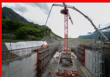
Coulage en cours de l'un des voiles latéraux de la tranchée couverte, dont l'épaisseur atteint 1 m.
