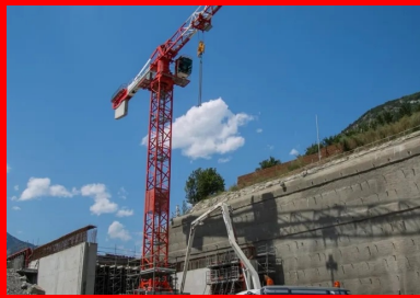
Pour contourner les difficultés d'accès, le béton est coulé par l'intermédiaire d'un camion-toupie équipé d'une pompe.
