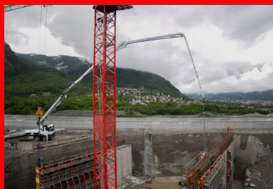
Le déploiement du bras de distribution articulé de la pompe à béton permet d'atteindre tous les points de coulage du chantier, même les plus difficilement accessibles, comme ici lors de la construction d'un voile latéral de l'ouvrage cadre.
