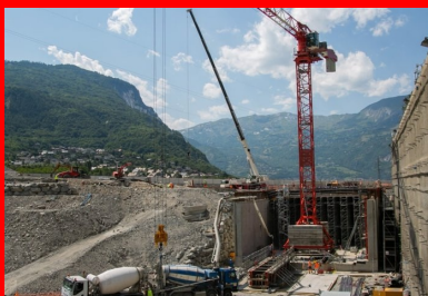
Les 9 000 m 3 des bétons de structure sont coulés en place. Le chantier dispose d'une centrale à béton principale située à Saint-Jean-de-Maurienne et d'une centrale de secours à Saint-Julien-Montdenis.
