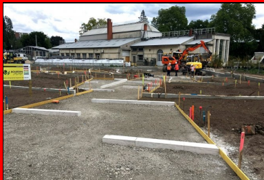
Les cheminements en béton du Jardin des plantes ont été réalisés en mars et avril 2019. Signe particulier : ils sont en béton blanc intégrant de gros granulats de calcaire local 0/60 (Pontijou, près de Blois), avec une finition bouchardée.
