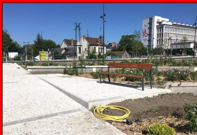
Les cheminements en béton du Jardin des plantes ont été réalisés en mars et avril 2019. Signe particulier : ils sont en béton blanc intégrant de gros granulats de calcaire local 0/60 (Pontijou, près de Blois), avec une finition bouchardée.
