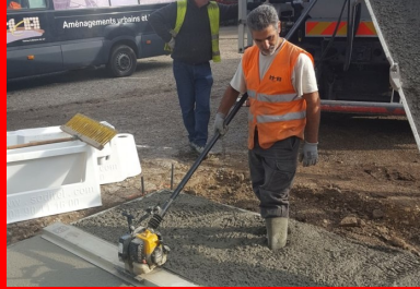
Le béton pompé a été réparti et égalé manuellement, puis vibré à la règle vibrante pour assurer son bon serrage.
