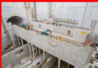
Le pont provisoire situé dans l'axe de la ligne 14 a permis de couler le hourdis inférieur du pont-cadre définitif.
