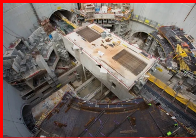
Dans un espace de travail particulièrement exigü, tous les travaux de Génie Civil se déroulaient en coactivité.
