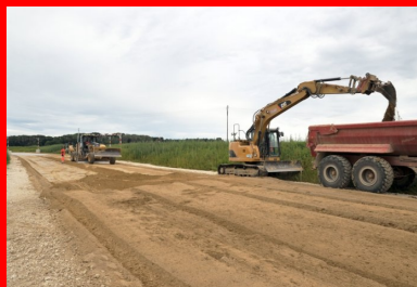
Les déblais, traités à la chaux, stockés et bûchés dans le périmètre du chantier, sont repris pour la réalisation de la couche de forme.
