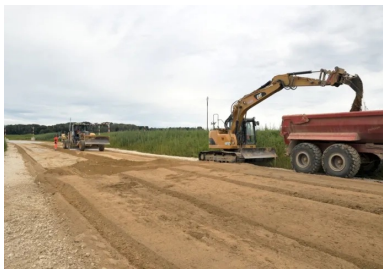
Les déblais, traités à la chaux, stockés et bâchés dans le périmètre du chantier, sont repris pour la réalisation de la couche de forme.
