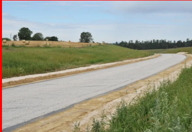
Un enduit gravillonné a été appliqué pour imperméabiliser la couche traitée et éviter la dessiccation.
