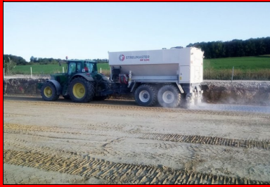
Le liant est épanché pour atteindre l'objectif d'un dosage de 5 %, avec vérification de la quantité épanchée à l'essai à la bâche.
