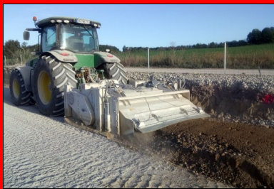
Le malaxage de la première couche est effectué avec un pulvimixeur de l'entreprise Brunner, sur une profondeur de 30 cm et une largeur de 1,80 m. Il nécessite trois passes complètes.
