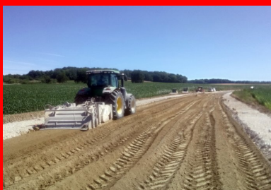
Juillet 2020. Vue générale du chantier de traitement de la couche de forme de la déviation de Ballersdorf, le plus important engagé récemment par le département du Haut-Rhin.
